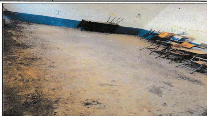
Foto 2: El piso de torta de concreto esta deteriorado no es ambiente agradable para los niños y niñas en su aprendizaje. Sus medidas son largo 7 mt y ancho 5 mt
