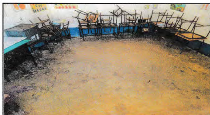
Foto 3: cambio por deterioro del piso de torta de concreto ya es necesario un remozamiento. Sus medidas son largo 5 mt y ancho 5 mt
